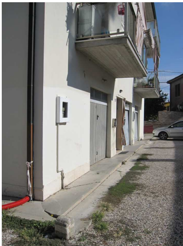
Esempio di cedimento strutturale dovuto alla liquefazione del suolo
