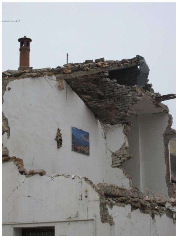
Esempio di vulnerabilità dovuto alla presenza nelle murature di legante incoerente
