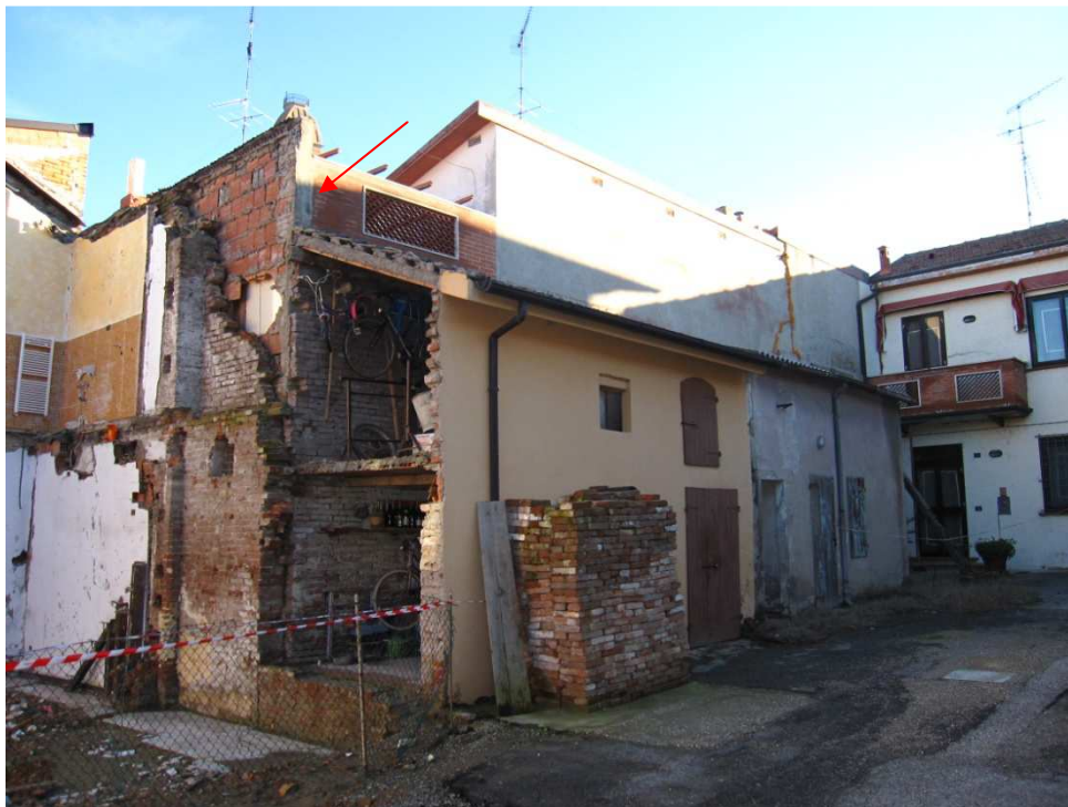
Esempio di vulnerabilità di murature perimetrali adiacenti non collegate e di diverso materiale.
